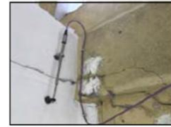
FESSURIMETRO SOTTO PORTICI
